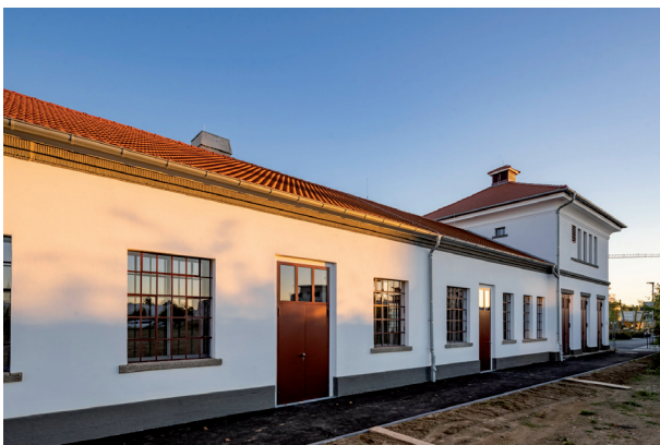
DSC_8004.jpg: Sämtliche Aussentüren des Werkstattgebäudes wurden aus dem Stahlsystem Janisol als verblechte Türen, teils mit einem Oberlicht, neu angefertigt.
