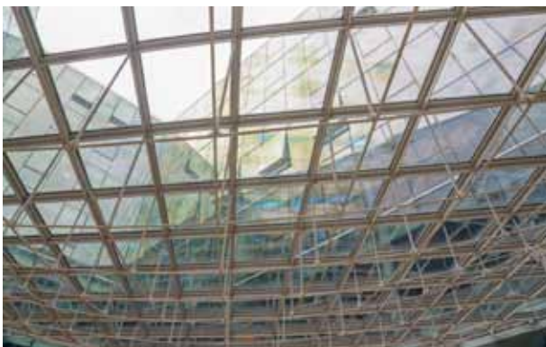
pic_04: Blick durch den „Ombrelle“, einen Glasschirm im Innenhof des Neubaus, auf die Brandschutz-Fassade aus dem Pfosten-/Riegelsystem Janisol 2.
