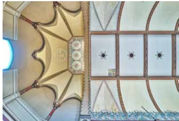
pic_06: Deckengewölbe: Aus Kostengründen wurden die Male-rien nur ansatzweise freigelegt.
