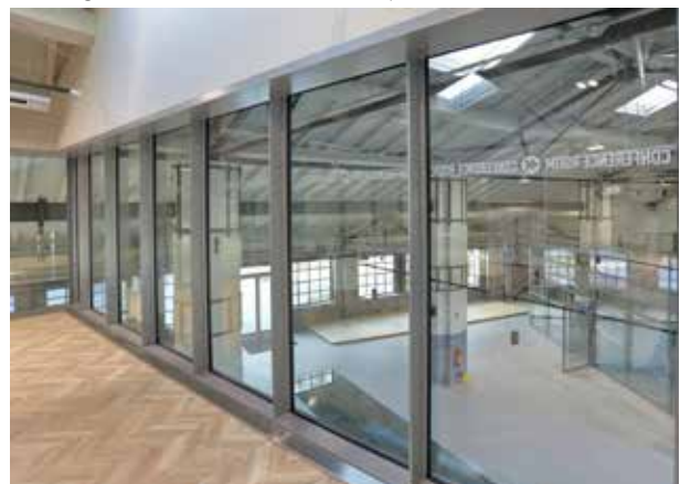
6307.jpg: Die obere Etage des zweigeschossigen Kubus ist als Konferenzraum konzipiert. Absturzsichernde Verglasung aus VSG 2fach Isolierglas und schlanken VISS-Linea Tragprofilen.
