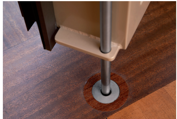
F4A0736x: Mithilfe von in den Massivdecken verankerten Bodenbuchsen können zum Lüften geöffnete Flügel arretiert werden.
