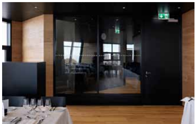
pic_08_efb_6572137.jpg: Die Türen in den verglasten Trennwänden dagegen sind vollverblecht; sie wurden mit Janisol 2 in der Brandschutzanforderung EI30 ausgeführt.
