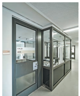
pic_10: Über den Erker (T30-Brandschutztüre mit F30-Festverglasung) sind die Flure vom Stationszimmer aus gut einsehbar.
